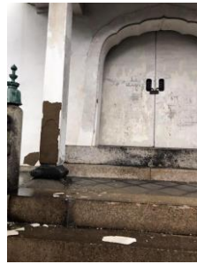
経蔵漆喰の剥離
