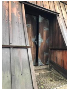
鐘楼の一部破損
