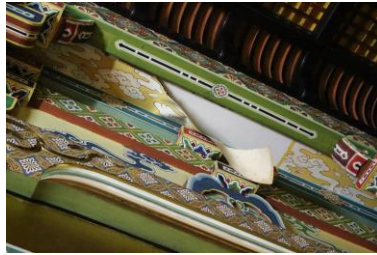
阿弥陀堂壁画の剥離
