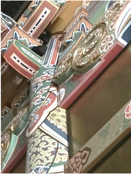
御影堂内陣柱の歪み
