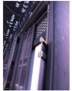
阿弥陀堂唐戸の破損
