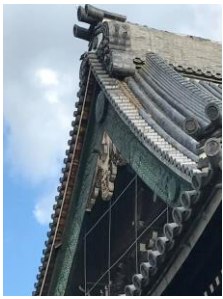
御影堂丸瓦の落下
